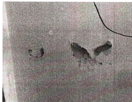
Foto 57 – Apodrecimento da alvenaria nas paredes laterais.
